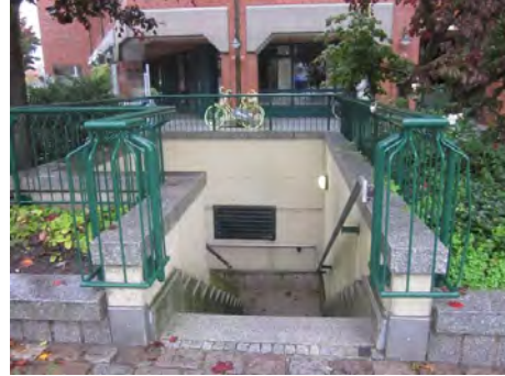
Zugang zur Tiefgarage mit unangenehmen Gerüchen
