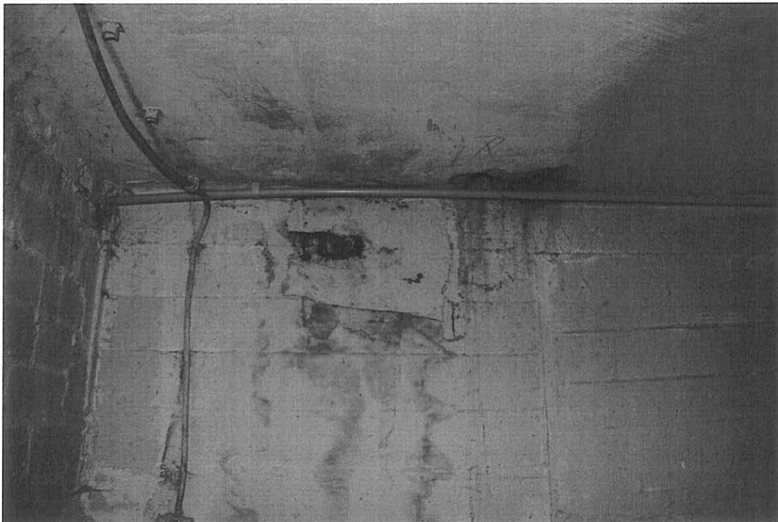
Foto 27 Wasserschaden?, Isolierung?, Malerarbeiten?
