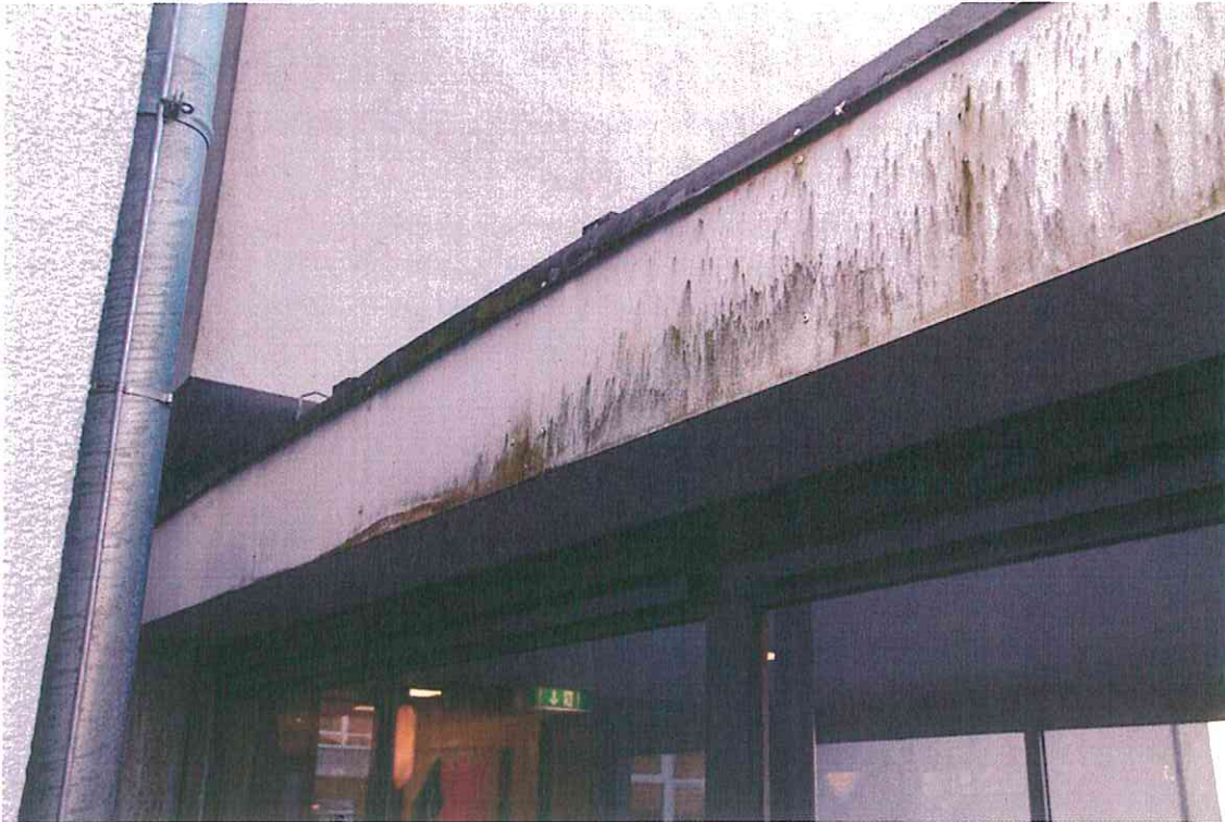
Foto 32 Regenschäden Dach / Verkleidung
