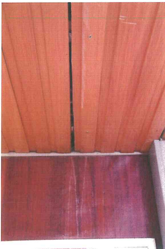
Foto 8 Beschädigung Decke und Wand
