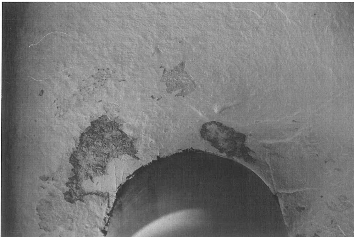
Foto 2 Abschluss eines Rohrs, Wasserschaden
