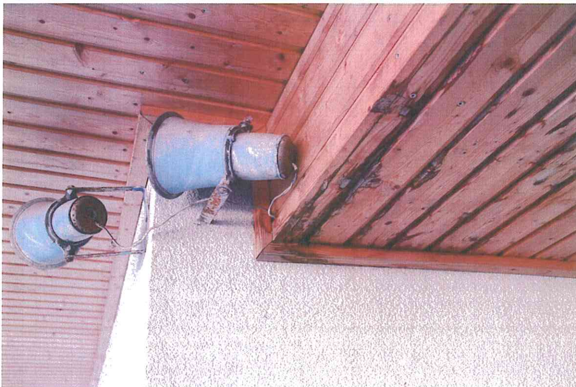
Foto 17 Lautsprecheranlage an „lebender“ Decke
