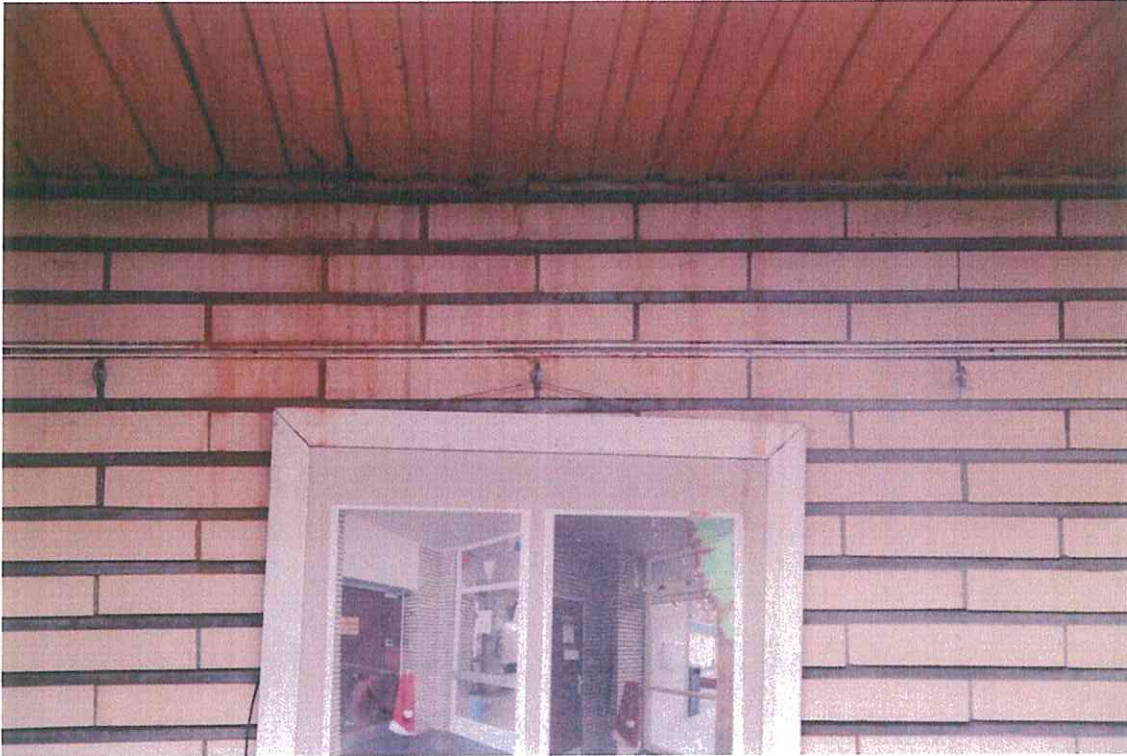
Foto 5 Wasserschaden, marode Täfelung der Decke, Wandreinigung „unmöglich“
