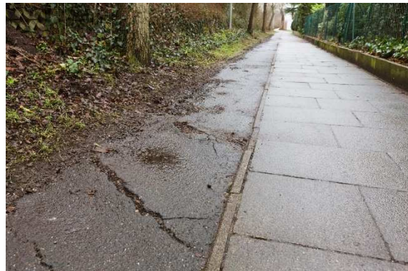
Abbildung 5: Schadhafte Oberfläche von Radverkehrsanlage an der Poppenbütteler Str. (Foto: Philipp Böhme)
