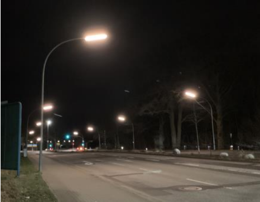
Foto 1: Kreuzungsbereich Oststraße / Harcksheyde Blickrichtung Einmündung der Harcksheyde in die Schleswig-Holstein-Straße, mit veralteten Kofferleuchten (Quelle: Norbert Pranzas am 23.02.2022)
