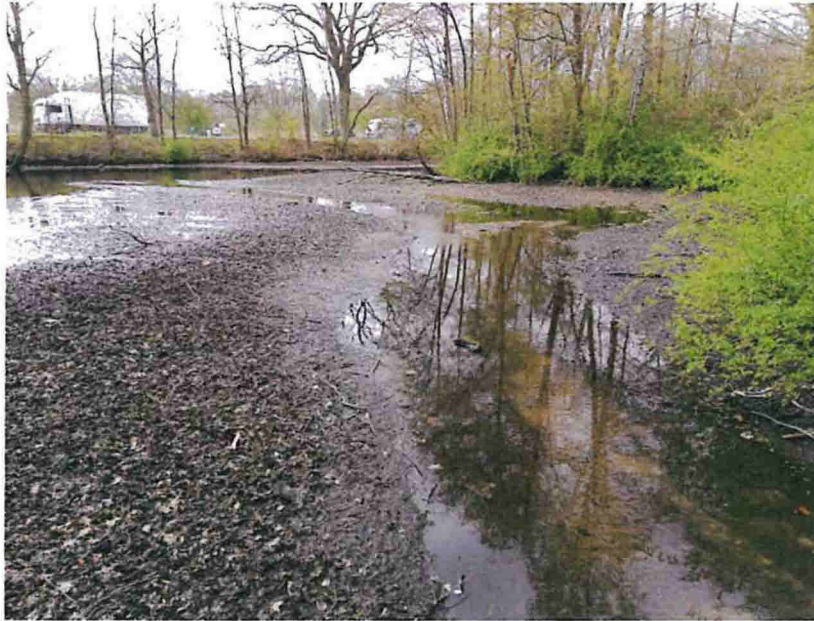
Bild 6: Wasserspiegel des RRBs drastisch gesenkt, so dass bereits jetzt ein gefährlich zu niedriger Wasserspiegel erkennbar ist.
