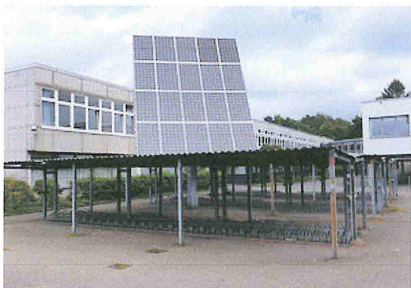
Foto: Drehbare PV-Anlage am Gymnasium Harksheide
